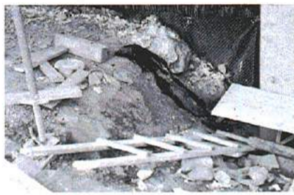
Déchets dans les fouilles de chantiers
