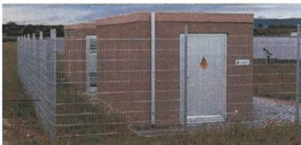
Figure 186 : Exemple de clôture et de postes onduleurs
