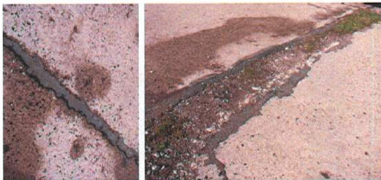
Figure 82 : Jointures entre 2 dalles de la piste
