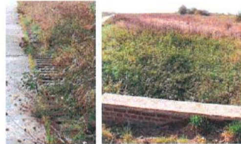
Figure 21 : Caniveau-grille et fosse au point bas du Petit Vallon (Sud-Ouest du site)
