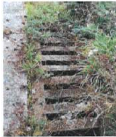
Figure 131 : Caniveau grille en béton sur le site
